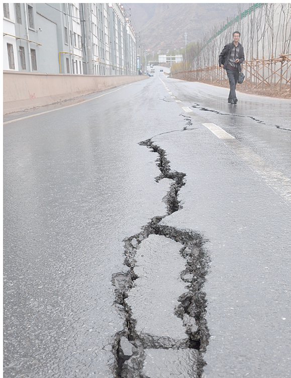
2017年4月26日,路面裂缝的状态。
