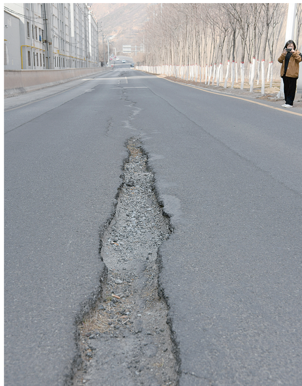
2024年3月15日,路面裂口的状态。
